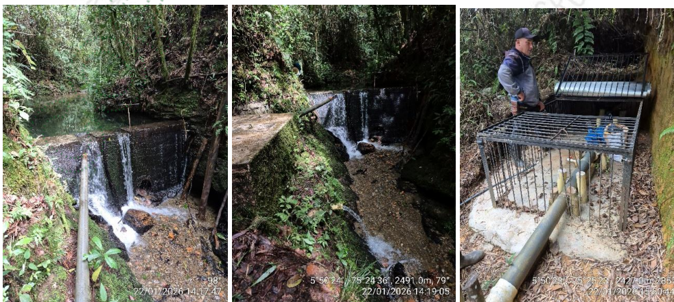
Imagen 1. De izquierda a derecha se observan el dique de captación, el desarenador y el macromedidor del sistema de acueducto.
